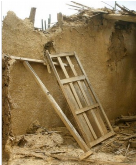
Casa de Barro en ruinas. Abudure. 27/03/2012.
